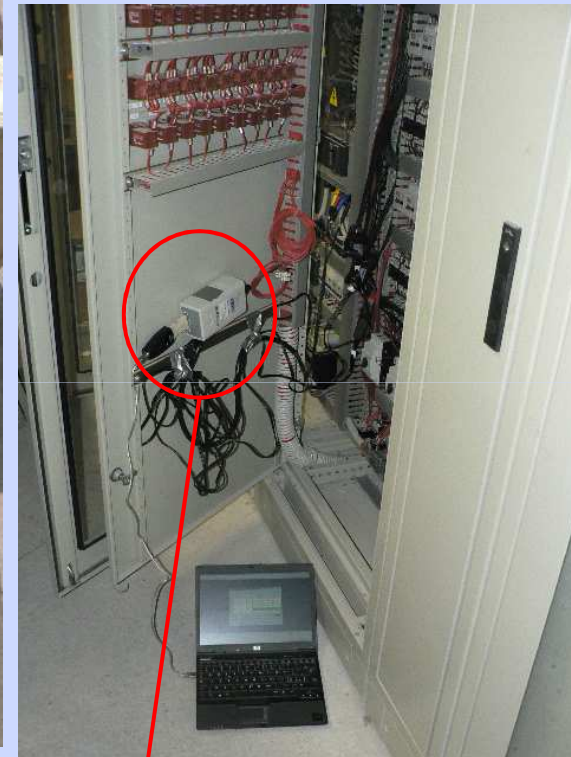
Misuratore di consumo elettrico installato nel quadro
